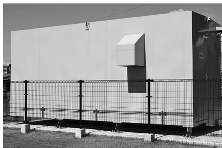
図2 コンテナ型電源装置外観
