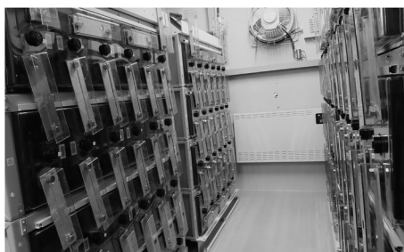
図3 コンテナ内の蓄電池
